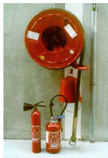
RIA et extincteurs
