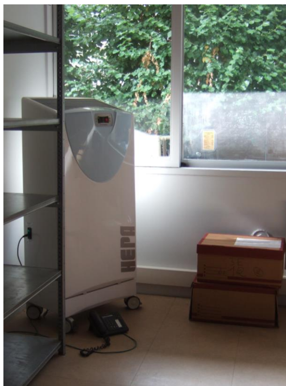
Purificateur d'air installé dans la salle de dépoussiérage des Archives départementales de la Seine-Maritime. ©Thi-Phuong Nguyen
