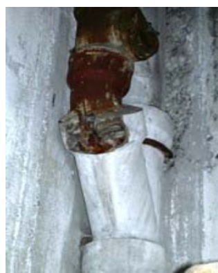
Ruptures de canalisation, fuites
